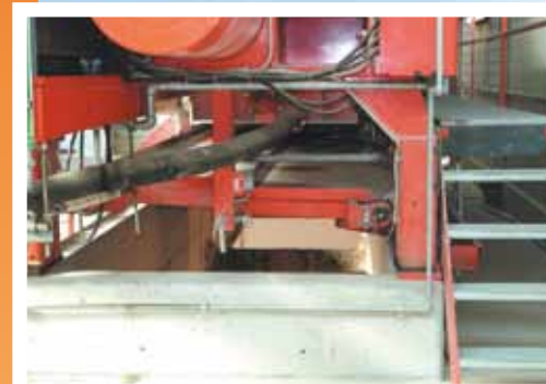
Chapa de recuperación de los goteos
